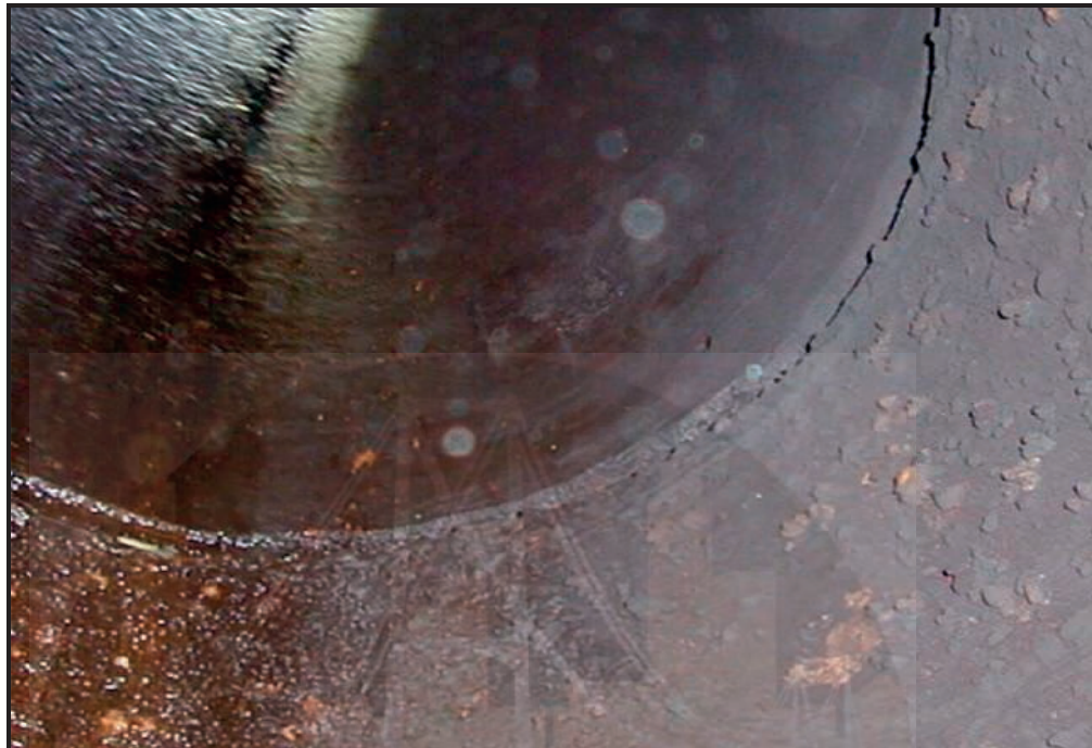
Figura 3-6: Tubérculos productos de la biocorrosión, presentes en la superficie de una tubería de acero recubierto con mortero de concreto.
