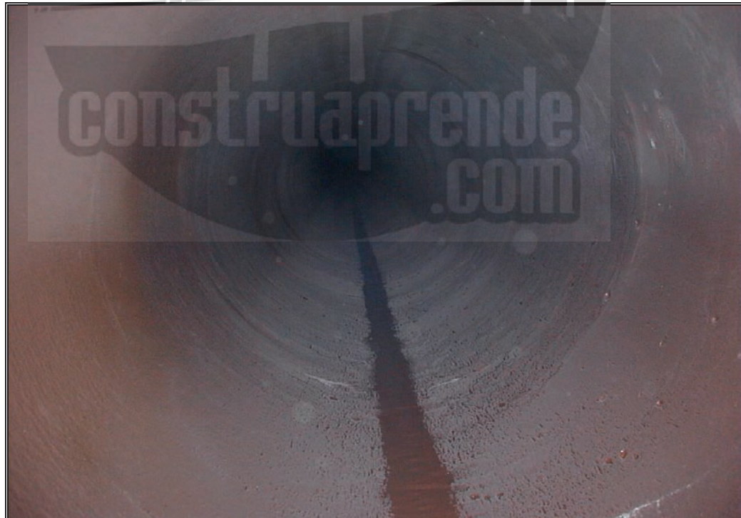
Figura 3-5: Capa de biopelícula de forma regular que se desarrolla en una tubería de concreto
