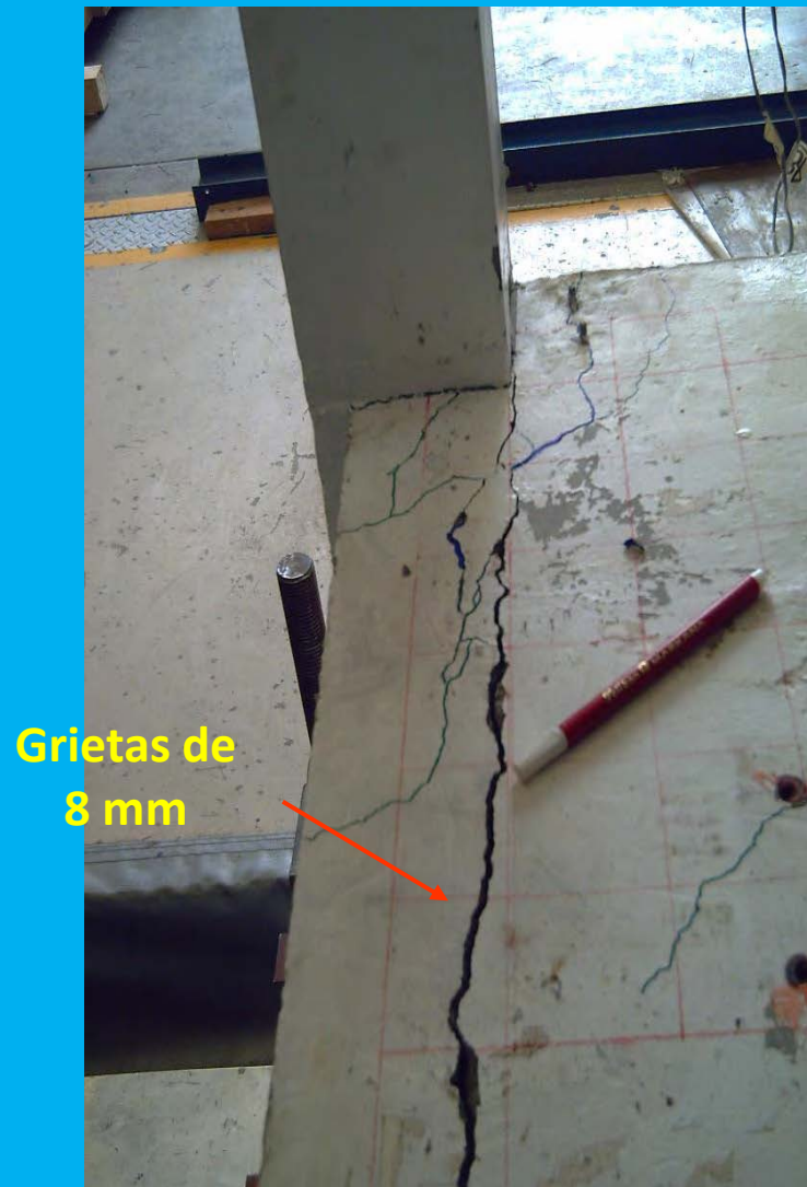
Fotografía de la losa cerca de Columna C-3 después de ensaye L1olleo 250%
